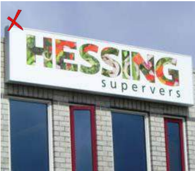
Lichtbakken hangen los aan gebouw en zijn niet geïntegreerd.
