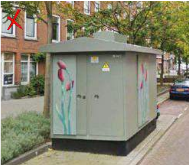
Installaties in de openbare ruimte.
